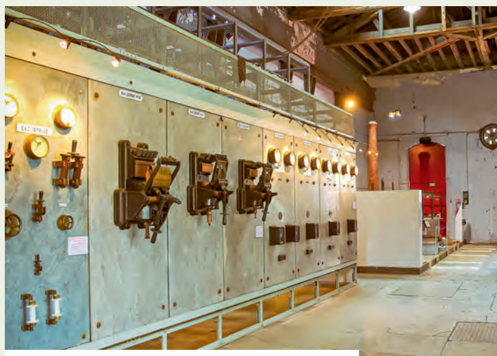
Disjoncteurs en fonte et en cuivre au musée du Saut du Tarn.
