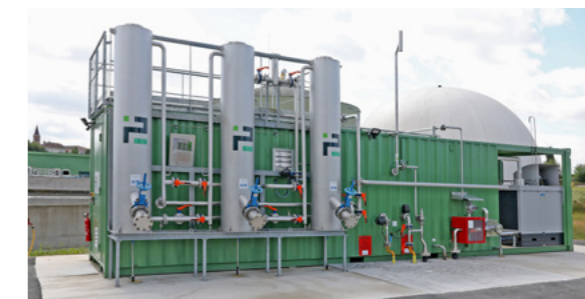
Unité de traitement de biogaz à la STEP Albi-Madeleine
