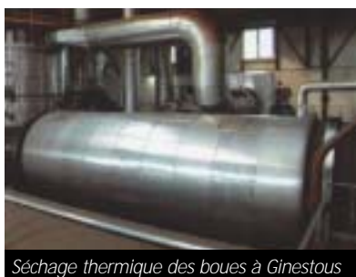
Séchage thermique des boues à Ginestous
